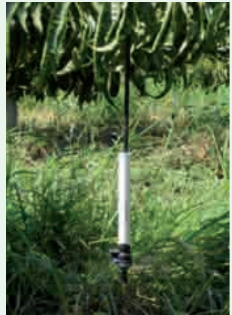
Particolare di un irrigatore a microaspersione
